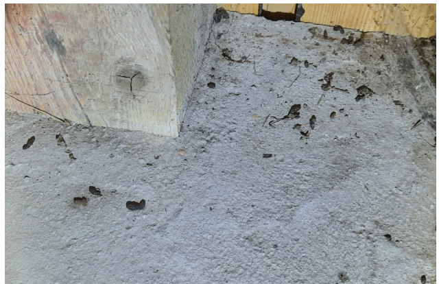
Abb. 21: Mäusekot am Boden des Schuppens.
