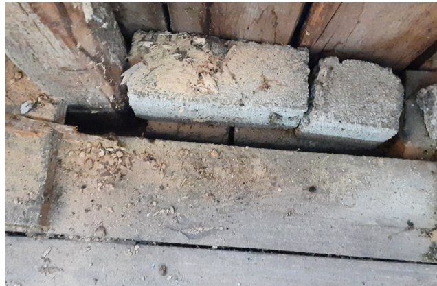
Abb. 14: Spalten als möglicher Zugang zum Zwischenboden.
