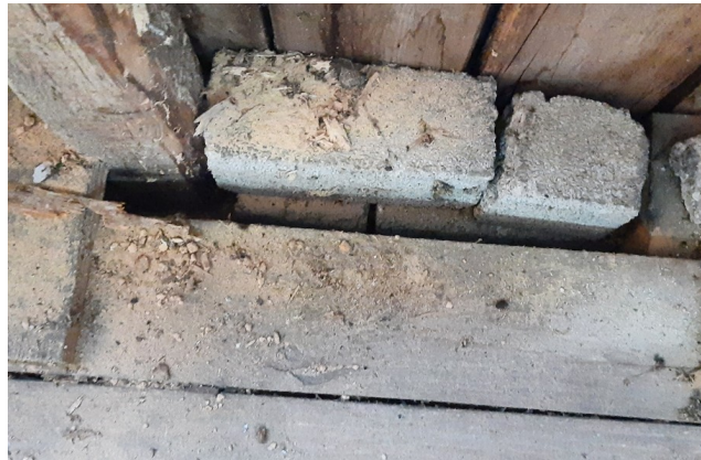
Abb. 14: Spalten als möglicher Zugang zum Zwischenboden.
