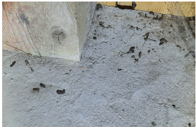
Abb. 21: Mäusekot am Boden des Schuppens.
