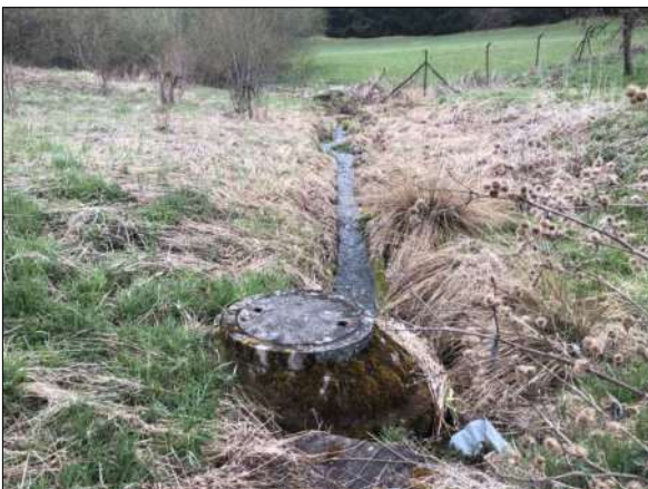
Das begradigte und ausgebaute (Sohlschalen) Langentalbächle im Plangebiet, das in einem Schacht endet.
